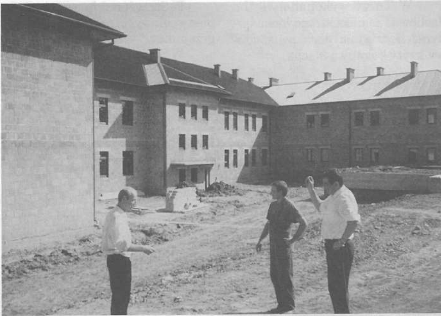
Kierownik budowy obiektu wielofunkcyjnego w Rzepienniku Biskupim Emil Sokulski z Szczytny (pierwszy z prawej w rozmowie z pracownikami: Dariuszem Bąkiem i Krzysztofem Jodłosiem) Aktualnie w budynku wykonywana jest instalacja elektryczna, wodno-kanalizacyjna i c.o. Układane są regipsy.
